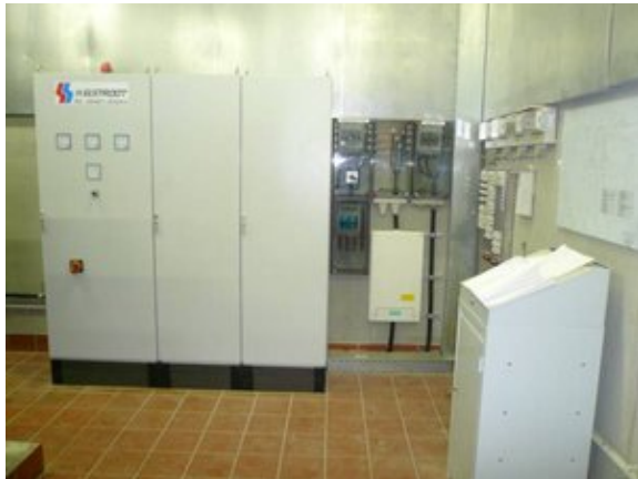
Schaltschrank als Unterverteilung f. Kesselregelungen
