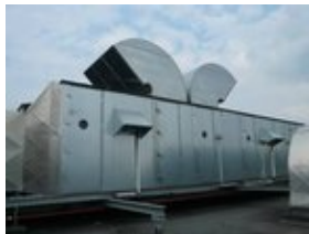
Kombinierte Zu-, und Abluftgeräte mit adiabater Kühlung (Hybridluftbefeuchter) Volumenstrom à 60.000 cbm/h
