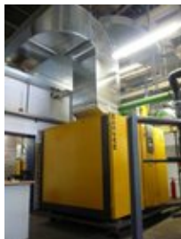
Drucklufttechnik mit Wärme-rückgewinnung
