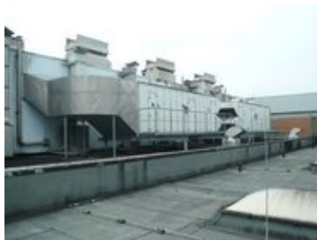
Zu-, bzw. Umluftgeräte mit adiabater Kühlung Volumenstrom à 60.000 cbm/h
