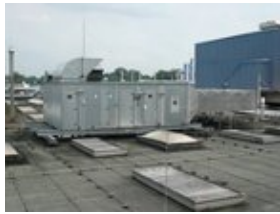
Lüftungsgeräte mit adiabater Kühlung (Kaldampfbefeuchter), Wärmerückgewinnung Volumenstrom à 40.000 cbm/h
